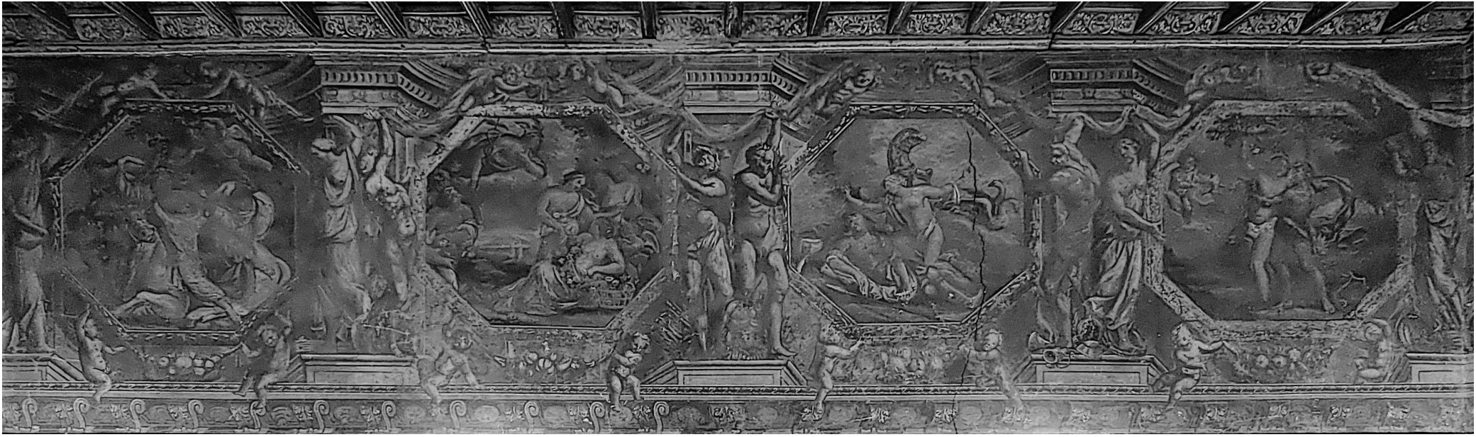
Fotopiano della fascia affrescata sulla parete interna ovest visualizzazione del quadro fessurativo esistente
